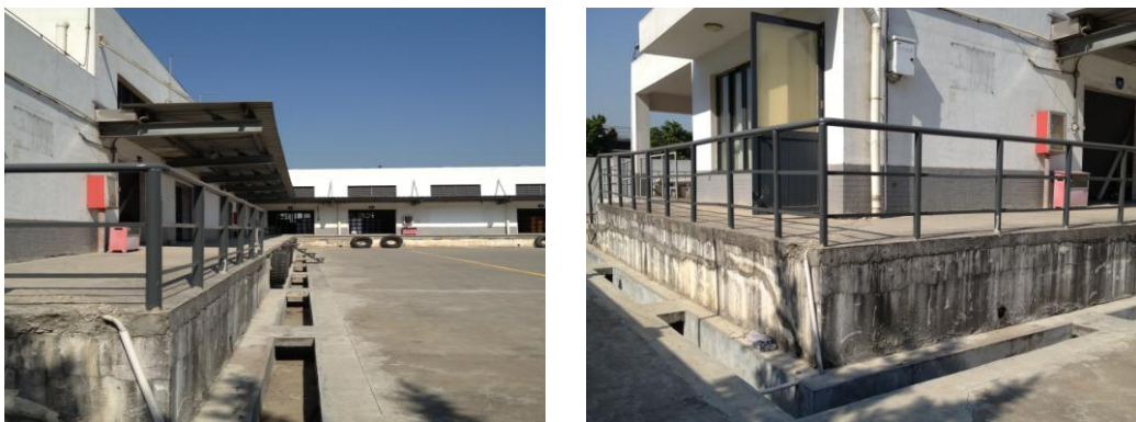
照片 8-11 油漆间环形事故沟
