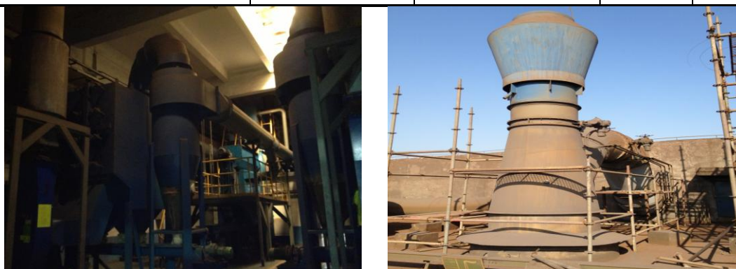
照片 3-1 除尘器及排放口
