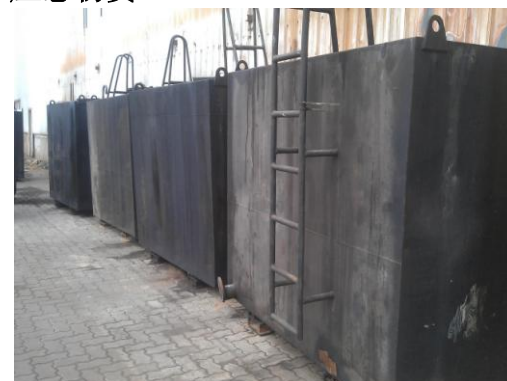
照片 8-16 应急油污柜
