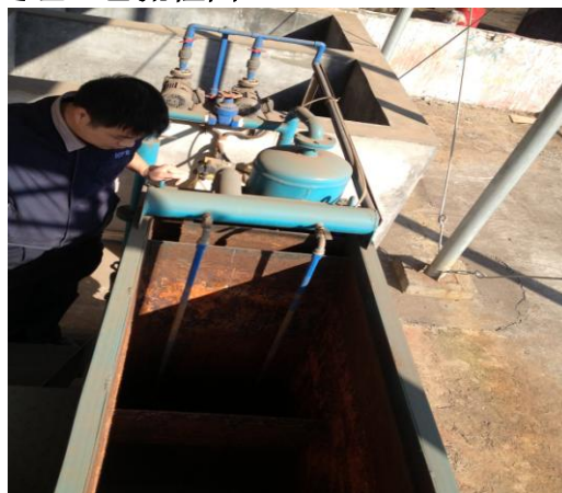
照片 3-4 含油废水处理设施
