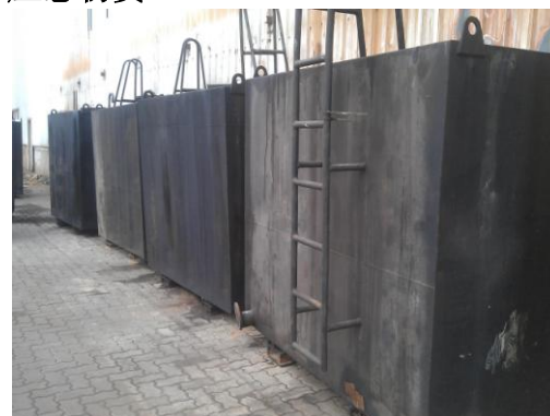
照片 8-16 应急污油柜
